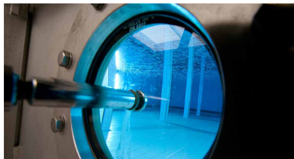
Reservatório de água de Wasserwerk Reinach und Umgebung
